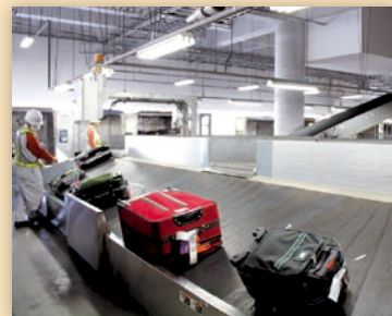
手荷物搬送設備
