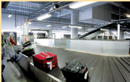
手荷物搬送設備
