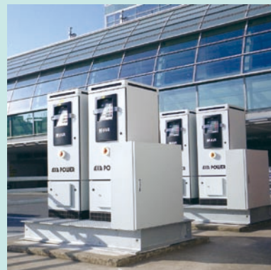
B787に対応した電力供給設備 (GPU)
