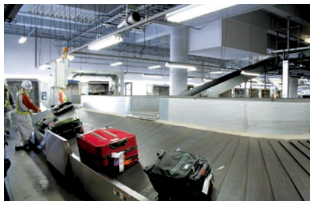
手荷物搬送設備
