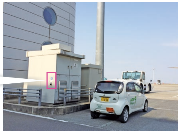
2013年設置分と合わせ、EV用充電設備を22基展開 (羽田空港制限区域内)
