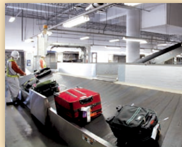
手荷物搬送設備
