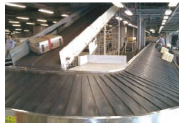
手荷物搬送設備
